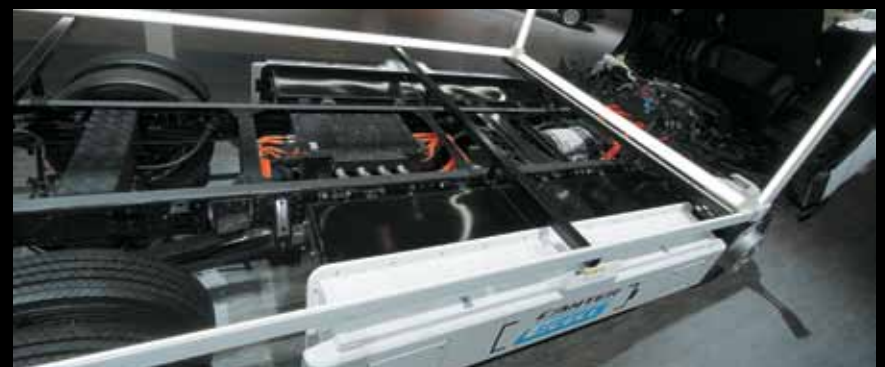
По обеим сторонам рамы — аккумуляторные батареи с воздушным охлаждением. Между лонжеронами — распределительная коробка
